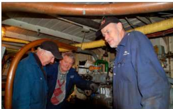
Samling vid pumpen. Från vänster Olle Everlund, Roger Hammarklint och Bosse Kullbom vid den ångdrivna Worthingtonpumpen i maskinrummets babordssida. Foto 15 februari 2018 Bo Starmark
